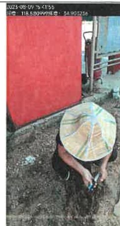
17# 地下柴油罐北土壤现场监测
